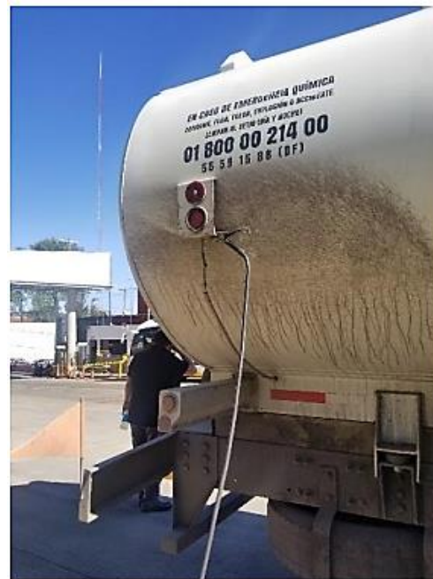
Ver figura 9. Cables de corriente conectados.
